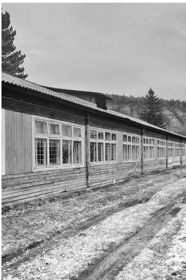
Школа в селе Шаманка включена в государственную программу и получит финансирование на проведение капитального ремонта
