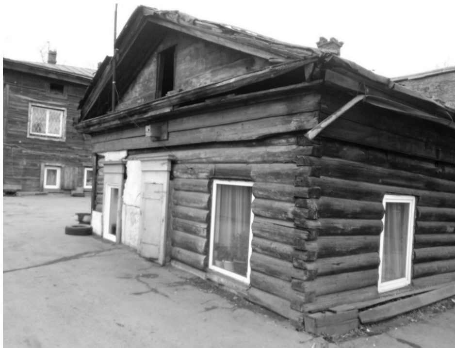
Фото 15. Северо-восточный фасад дома под лит. б.
