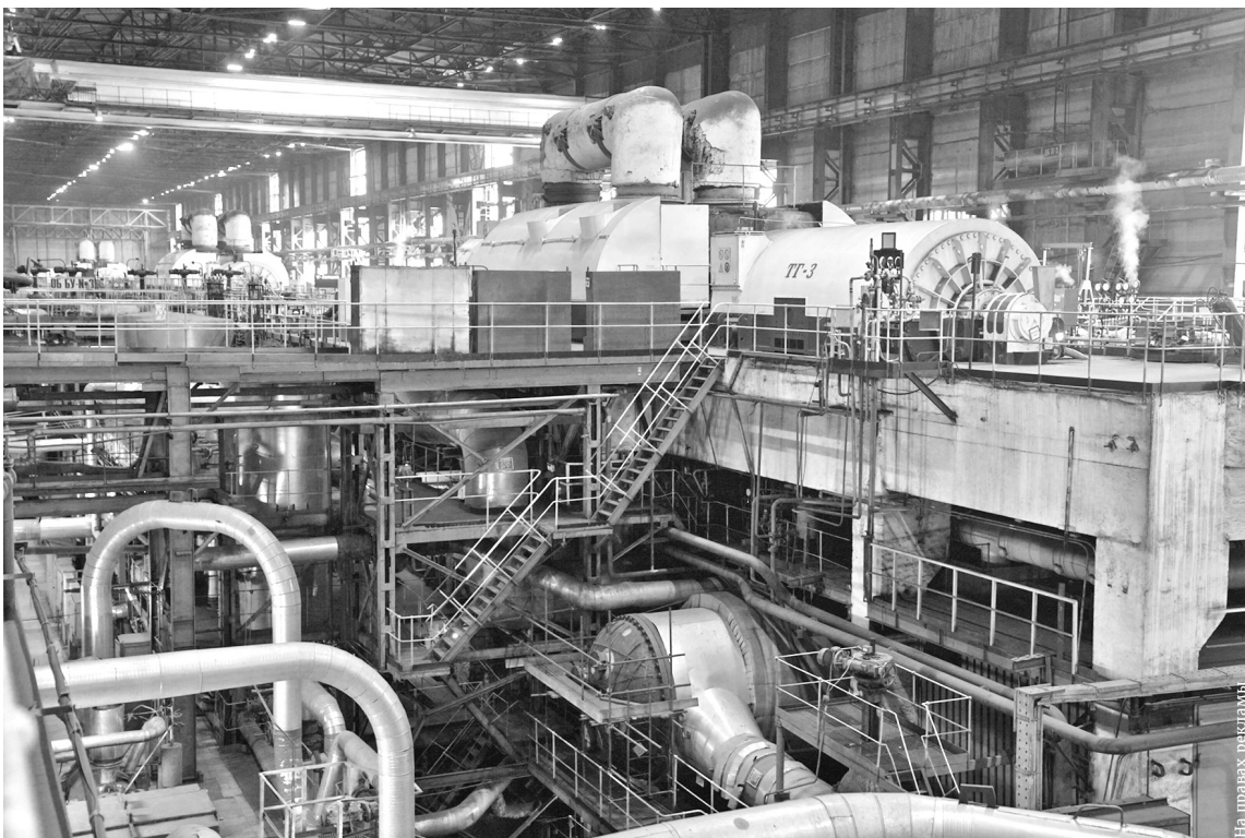
На Ново-Иркутской ТЭЦ реализуется проект по модернизации, что позволяет повышать надежность теплоисточника и снижать выбросы в атмосферу. В планах Эн+ построить здесь два новых котла
