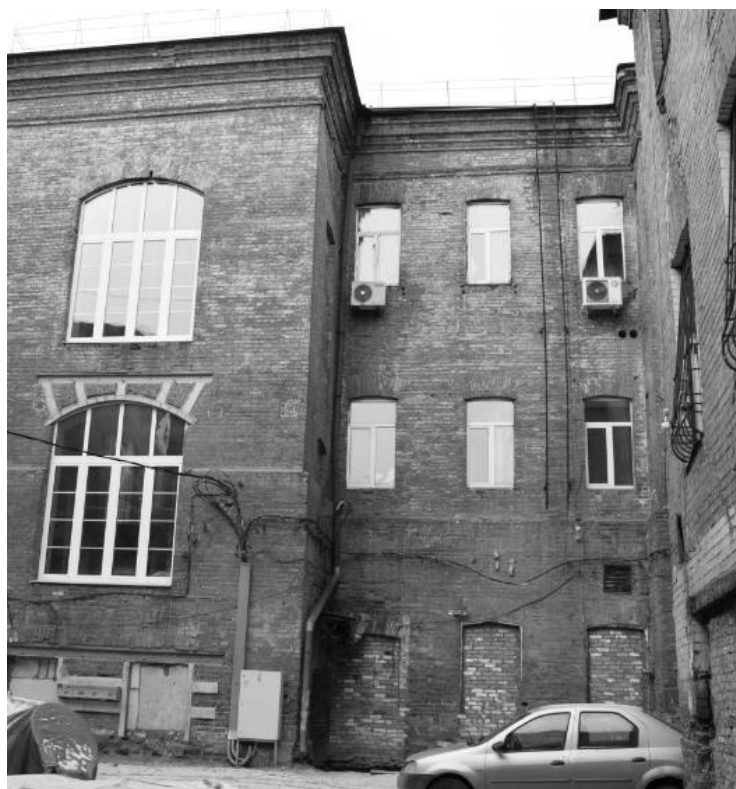
Вид на фрагмент дворового (северо-восточного) фасада здания в части блока бывш.доходного дома. Видоизмененные перемычки некоторых проемов, заложены некоторые проемы, деструкция кирпичной кладки, частично отсутствуют водостоки.
