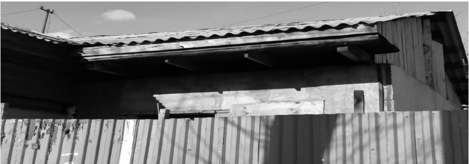
Жилой дом (лит Б). Поздний пристрой сеней из шлакоблоков.
