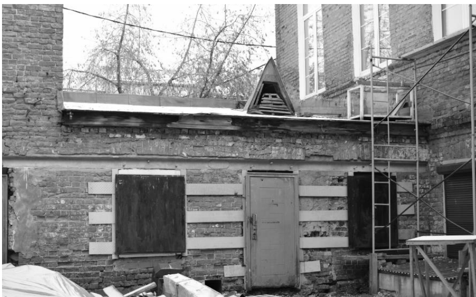
Вид на юго-западный фасад здания в части блока бывш.хоз.постройки. Видоизмененные перемычки проемов, деструкция кирпичной кладки, отсутствие водостоков, частичные утраты фриза, карниза.
