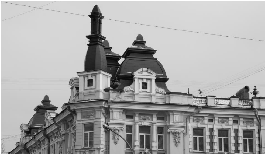
Фрагмент юго-западного фасада здания со стороны ул. Литвинова. Купола, башенка, декоративное оформление в уровне кровли. Частичные утраты декоративных элементов (вазоны, балясины ограждения).
