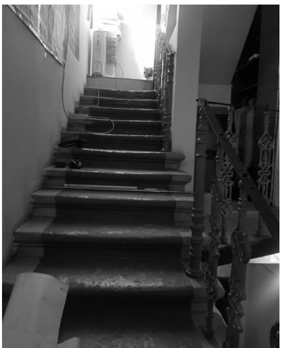
Фрагмент служебной лестницы, расположенной в блоке бывш. доходного дома в корпусе по ул. К. Маркса. Вход на нее организован со стороны двора. Частичные утраты ограждения, ступеней.
