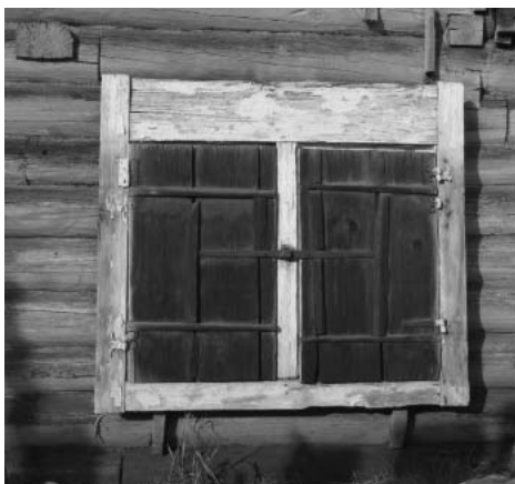
7. Фрагмент бокового (юго-восточного) фасада в уровне 1 этажа. Оконный проем. Автор снимка: Кравченко В.И. Дата съемки: февраль 2017 г.
