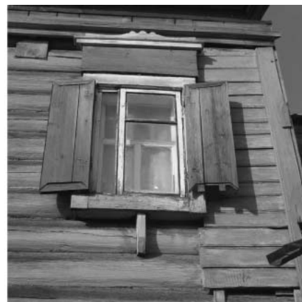
8. Фрагмент бокового (юго-восточного) фасада в уровне 2 этажа. Оконный проем. Автор снимка: Кравченко В.И. Дата съемки: февраль 2017 г.
