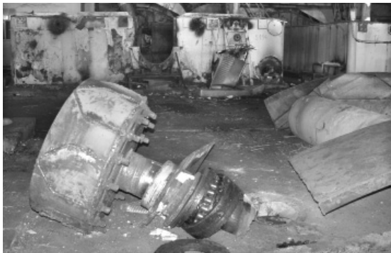
Демонтаж оборудования ведется без проекта, утвержденного госэкспертизой промышленной безопасности
