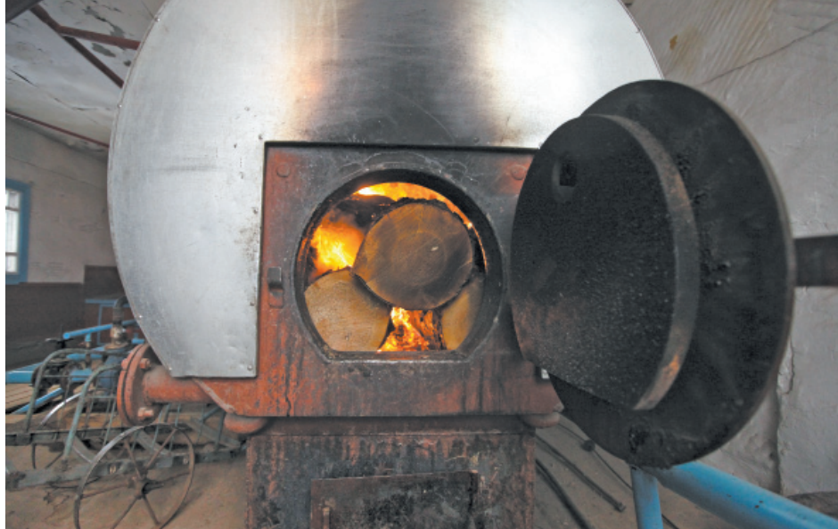
В центральной котельной, которая топит школу, клуб и больницу, установили новый котел томского производства
