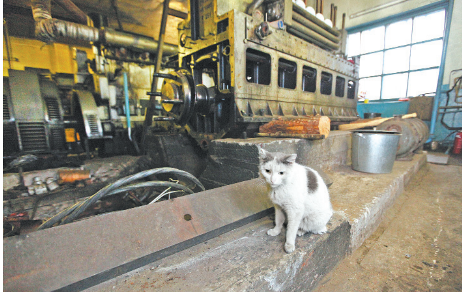
Местная дизельная станция
