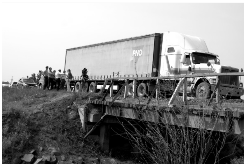
Мост через реку Азейку в Тулунском районе находится в аварийном состоянии
