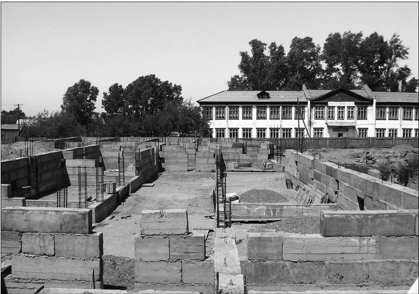
В пяти метрах от входа в школу в поселке Усть-Уда уже много лет красуется опасный долгострой
