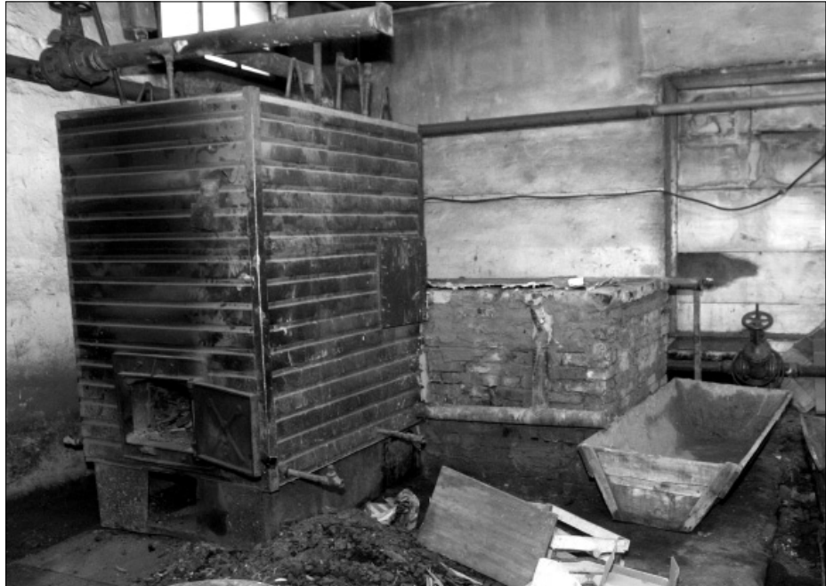
«Модернизированная» котельная стала причиной несчастного случая в Порту Байкал
