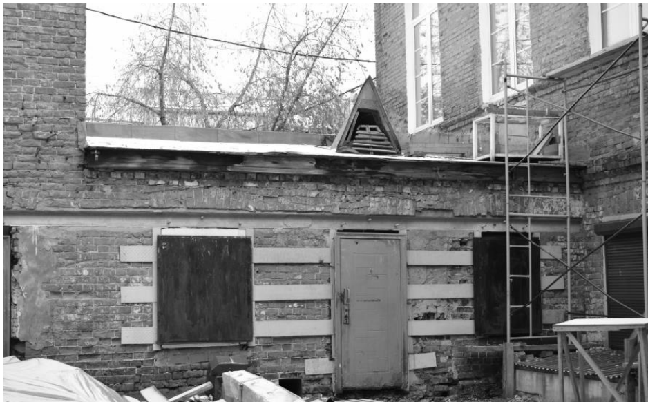
Вид на юго-западный фасад здания в части блока бывш.хоз.постройки. Видоизмененные перемычки проемов, деструкция кирпичной кладки, отсутствие водостоков, частичные утраты фриза, карниза.
