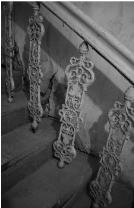
Фрагмент служебной лестницы, расположенной в блоке бывш. доходного дома в корпусе по ул. К. Маркса. Вход на нее организован со стороны двора. Частичные утраты ограждения, ступеней.
