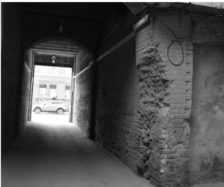
Фрагмент северо-восточного фасада здания со стороны двора. Сквозной арочный проезд. Деструкция кирпичной кладки.
