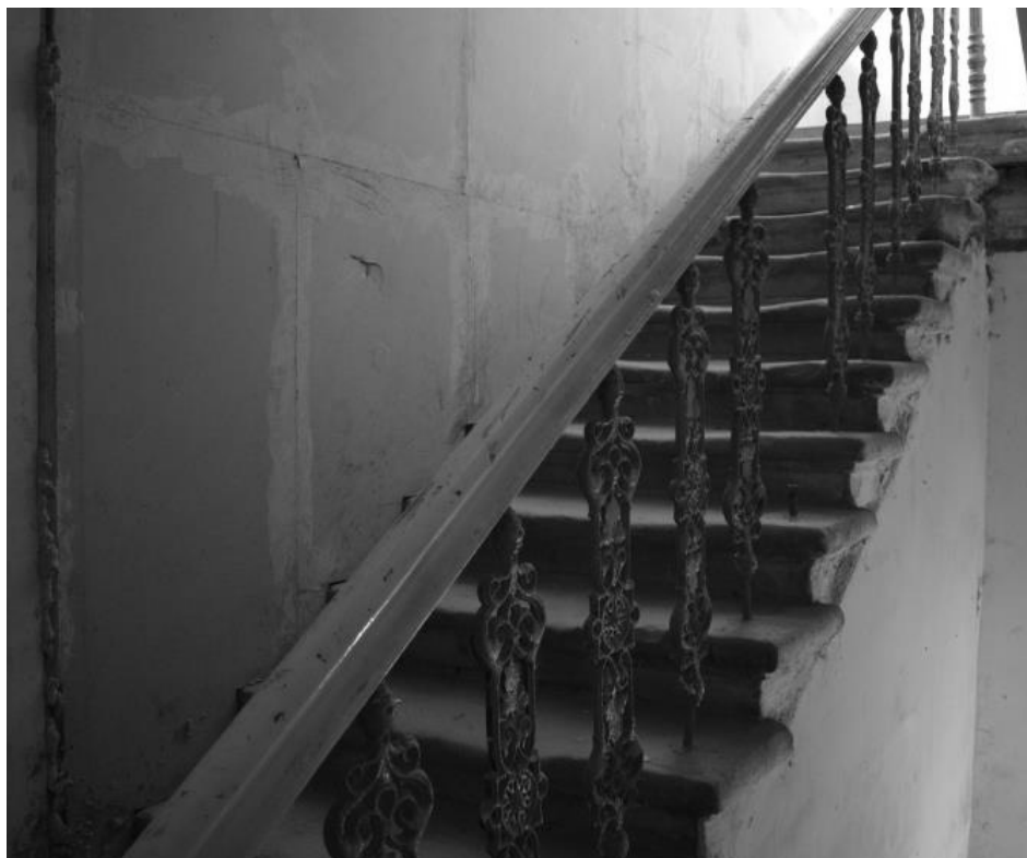
Фрагмент служебной лестницы, расположенной в блоке бывш.доходного дома в корпусе по ул.К.Маркса. Вход на нее организован со стороны двора. Частичные утраты ограждения, ступеней.
