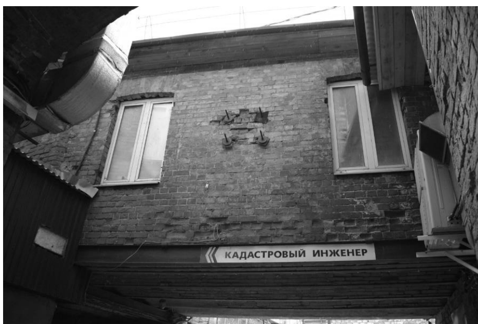
Фрагмент юго-западного фасада здания в части галереи-перехода. Деструкция кирпичной кладки.
