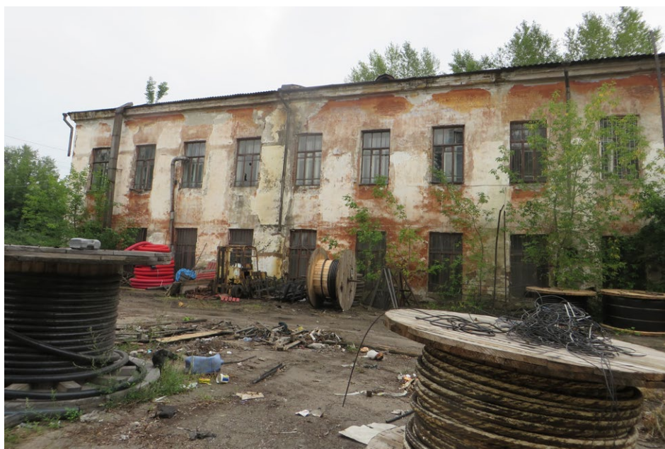
Северный фасад дворового объема.
