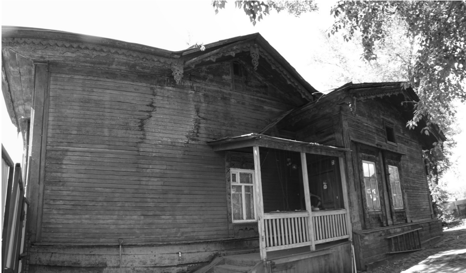
Фрагмент бокового (юго-восточного) фасада. Вход. Следы замачивания стен здания.
