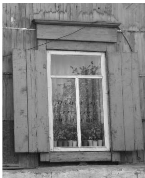
Дата съемки: май, 2011 г. Фото 4 - Фрагмент северо-восточного фасада здания. Оконный проем.
