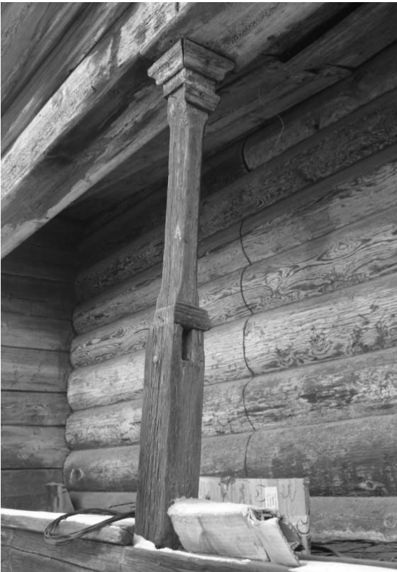
Фото Д.Н. Шастун, март 2019 г. Угол примыкания амбара к кирпичному объему. (Амбар лит.Е) Утраты ограждения.
