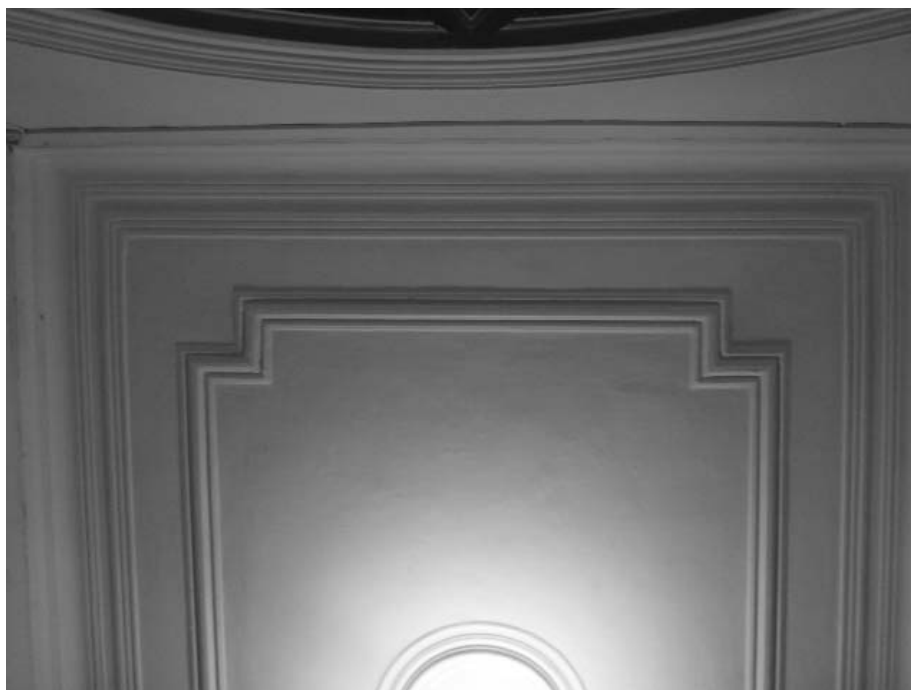
Фото 48 - Первый этаж. Помещение 17. Потолок
