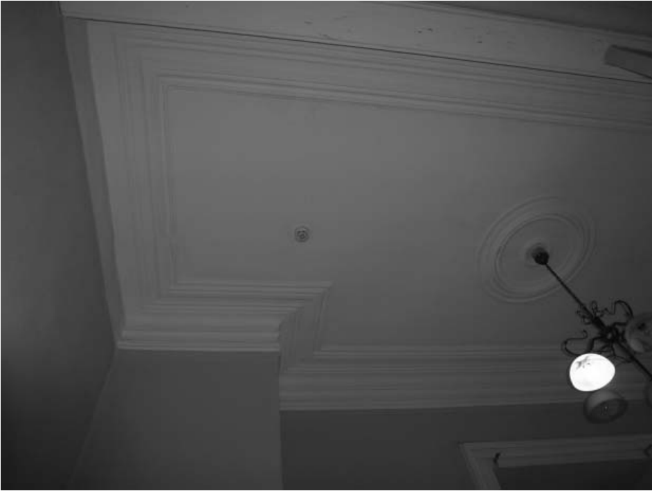
Фото 53 - Первый этаж. Помещения 4, 5. Потолок
