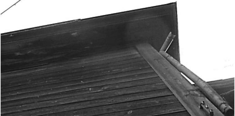
Фото 6. Фрагмент фасада. Неудовлетворительное состояние подшивного карниза
