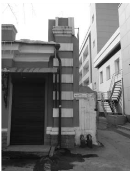
Фото 13. Торец брандмауэрной стены
