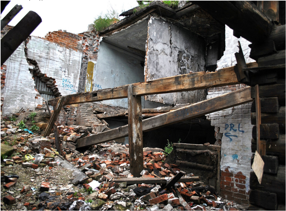
Фото 13. Ул. Грязнова, 34, лит. Б. ОКН «Застройка ул. Грязнова. Усадьба Ковалёвой: два жилых дома». Общий вид со двора. Разрушенные галерея, юго-восточная стена основного объема и лестничная клетка. Фото 2017 г.
