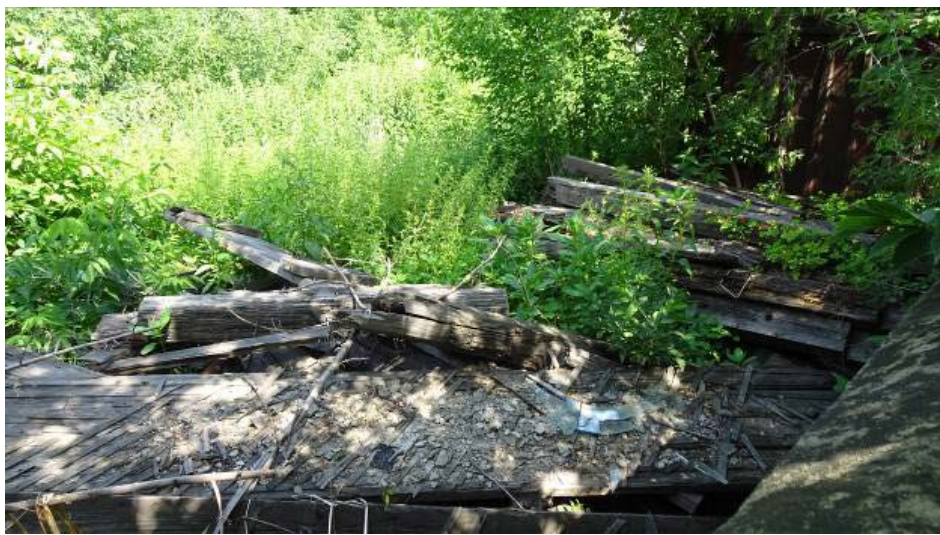
Фото 16 - Строение лит.Б: прачечная в руинированном состоянии
