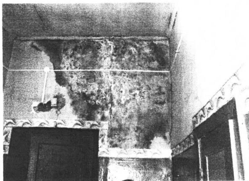
Интерьер. Поражение кирпичной кладки грибком, в результате постоянного намокания, характерное состояние стен здания.
