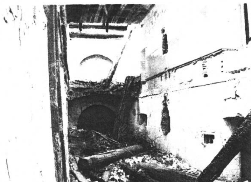
Интерьер. Коридор Г-образного корпуса вид с северо-западной стороны. Неэксплуатируемая часть здания, пострадавшая во время пожара.
