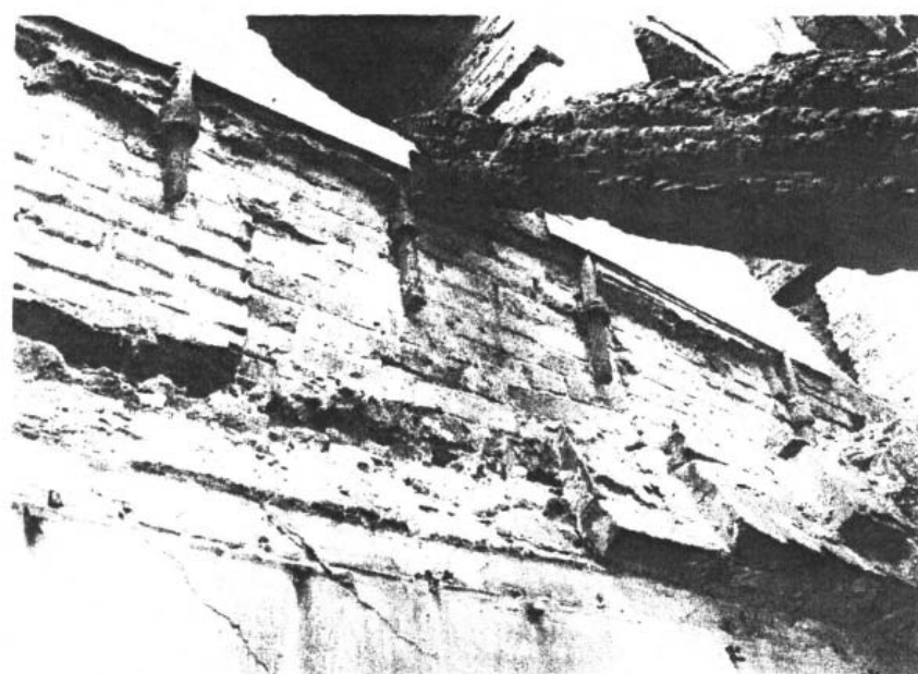
Интерьер. Коридор Г-образного корпуса. Участок потолка разрушенного свода. Видны концы металлических затяжек.
