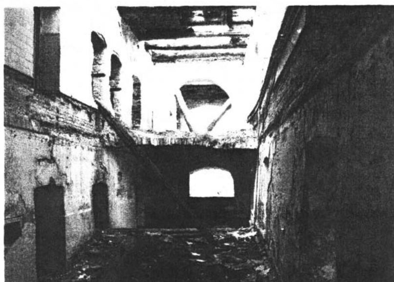
Интерьер. Коридор Г-образного блока вид с юго-восточной стороны. Участок разрушенного сводчатого перекрытия.
