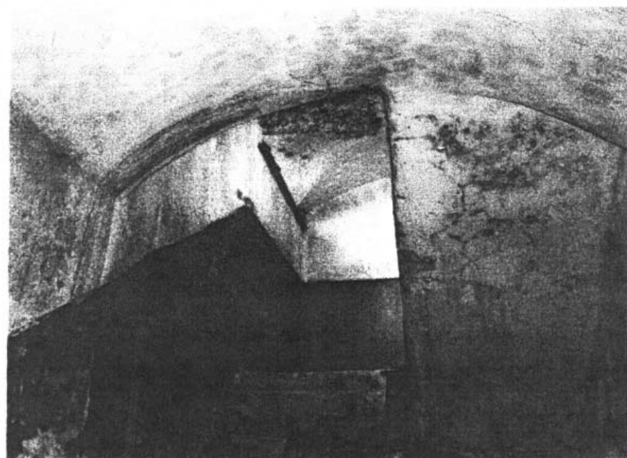
Интерьер. Лестничная клетка в разрушенной части здания.
