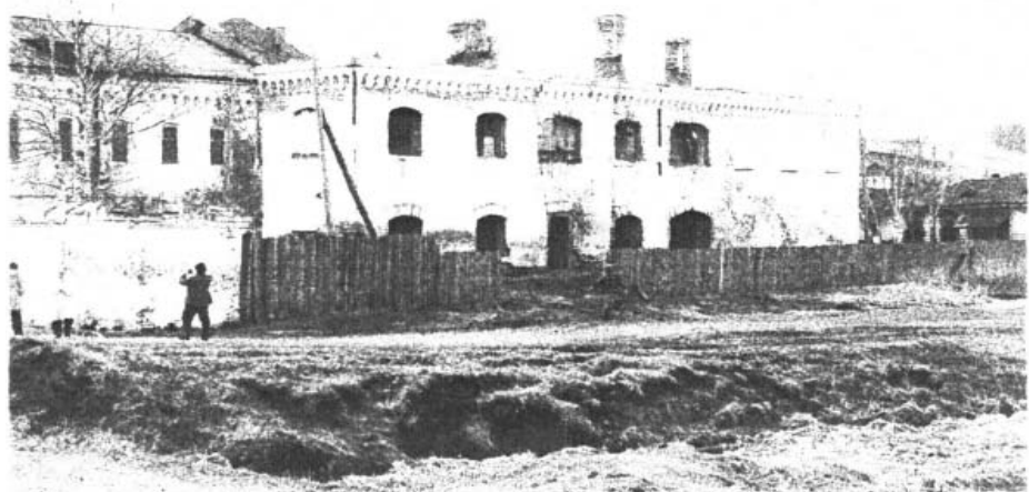
Фрагмент Северо-западного фасада, не эксплуатируемый блок здания, пострадавший во время пожара.
