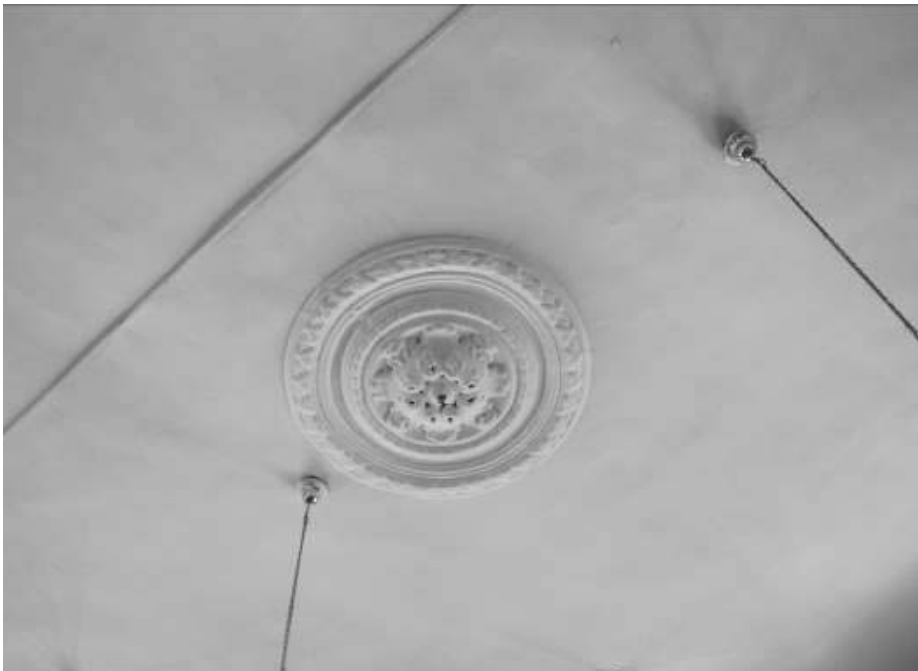
Розетка. Помещение № 8 (в соответствии с техническим паспортом ОГУП «ОЦТИ – Областное БТИ» г. Иркутск по состоянию на 20 декабря 2014 года)
